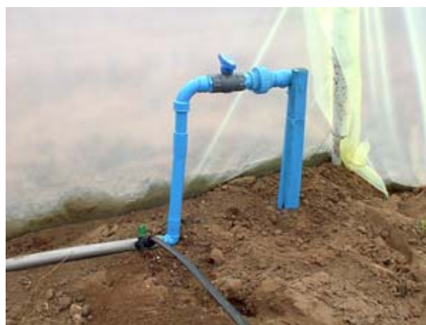
Llave de campo, línea secundaria y lateral de riego
