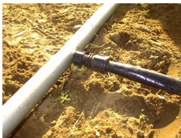
Línea secundaria v lateral de riego
